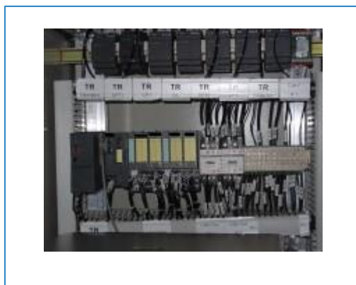
■ Automates situés dans l'armoire DOF1-Sol
