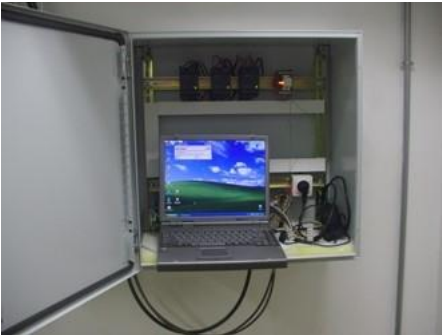
■ Photo de l'interface d'enregistrement (data logger)
