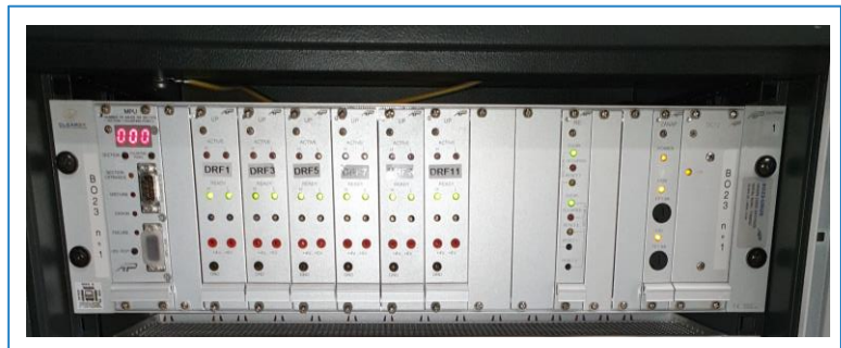
■ Rack compteur d'essieux en armoire
