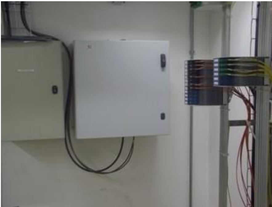
■ Photo de l'armoire (située dans le local technique)
