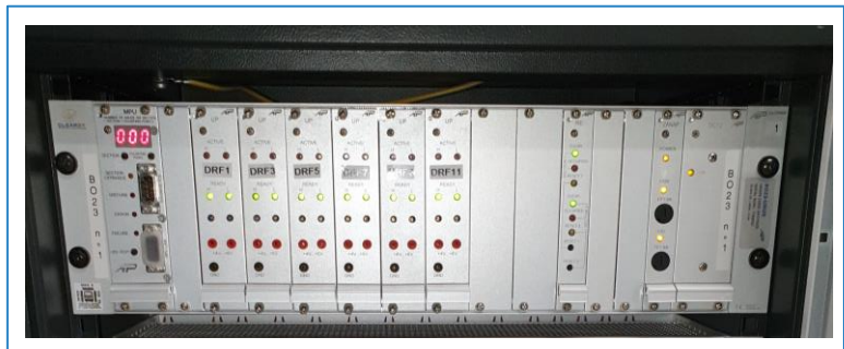
■ Rack compteur d'essieux en armoire
