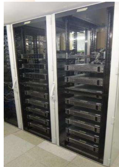
Le matériel du banc d'essai RBC est installé dans une armoire avec l'équipement testé.
